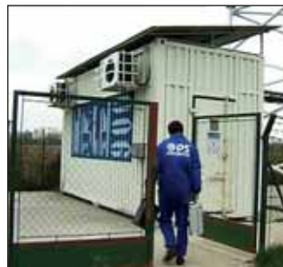
7. ábra. Westel (T-Mobile) állomás
